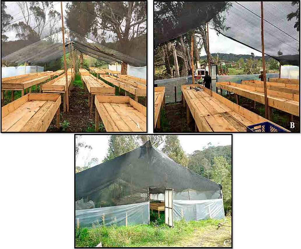
Figura 14. Panorámicas generales del vivero terminado A-B . Vista general del interior del vivero, el techo y las camas de germinación y crecimiento, también se observa en las partes laterales la cubierta de plástico; C . Vista de la entrada principal del vivero.
