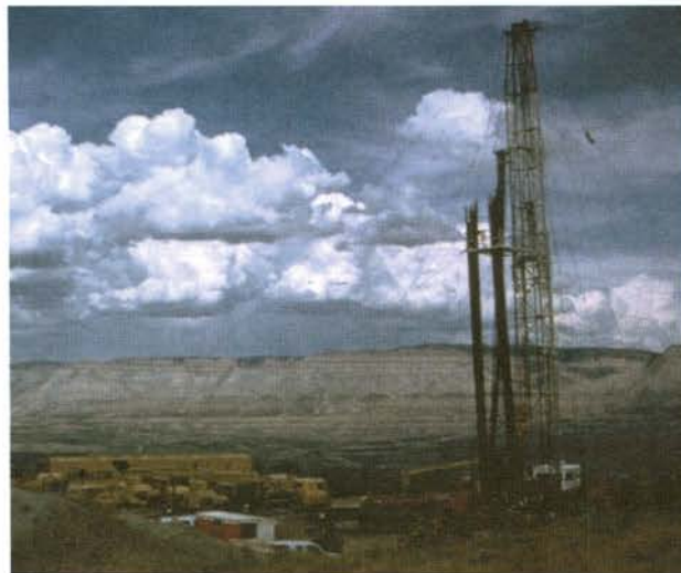
Figura 10.6 Arriba, machín de bombeo drenando un reservorio de carbón en la cuenca Powder River, Wyoming (EUA). Abajo, pozo profundo de CBM en Colorado, donde se alcanzaron los 2700 m.
