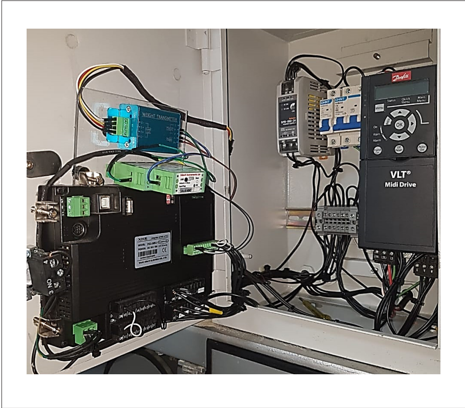
Figura 43. Conexión eléctrica del tribómetro [Autor].
