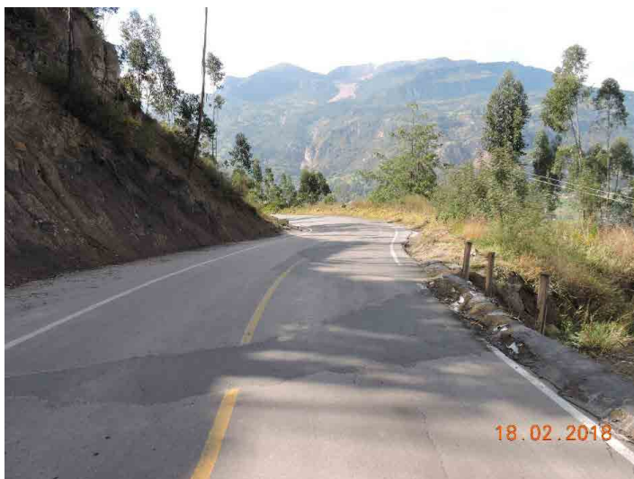
Figura 2-12 PR32+900 – Altas deformaciones en el pavimento
