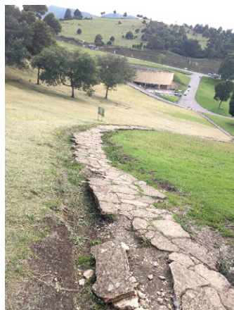
Imágenes 44 y 45. Desgaste, desprendimiento, erosión, extracción y fragmentación de las losas de piedra. Fuente: Parra, G., Gonzales, D., Rojas, G, 2017.
