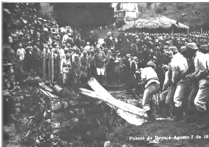
Imagen 10. Sustitución de los durmientes del Puente de Boyacá. Fuente: El Gráfico, Bogotá, agosto 16 de 1919 Nros. 485-486; p. 279.
