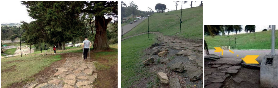
Imágenes 513, 514 y 515. Estado de senderos y caminos. Fuente: Equipo PEMP 2017.
