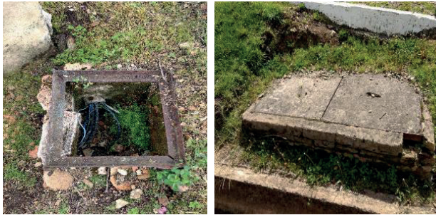
Imagen 171. (izq) Caja de inspección de energía con cables de baja tensión expuestos. Imagen 172. (der) Caja de inspección de energía con capa vegetal. Fuente: Equipo PEMP 2017
