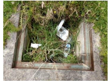
Caja de inspección de energía- Nivel de deterioro alto
