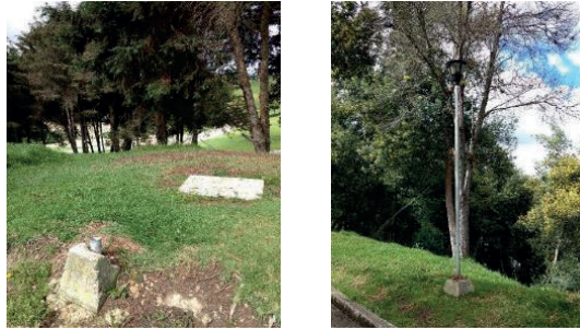
Imagen 181 Luminarias tipo 1 ornamental - pedestal con fallas (izq.) y sin fallas (izq.) Fuente: Equipo PEMP 2017
