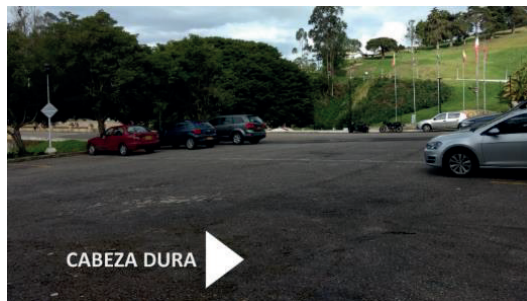
Imagen 156. Patología zona de parqueo 3. Cabeza dura. Fuente: Equipo PEMP 2017
