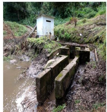
Estación de Bombeo de agua – Red Interna
