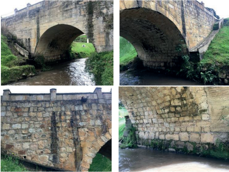
Imágenes 235, 236, 237 y 238. Estado del puente de calicanto. Fuente: Equipo PEMP.
