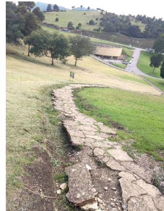
Imágenes 44 y 45. Desgaste, desprendimiento, erosión, extracción y fragmentación de las losas de piedra. Fuente: Parra, G., Gonzales, D., Rojas, G, 2017.
