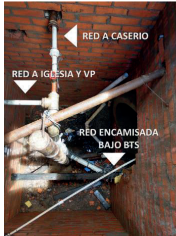
Imagen 163. Pozo de Inspección adyacente a vía BTS Fuente: Equipo PEMP 2017
