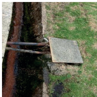
Imagen 197. Cajas de inspección agua con tapa
