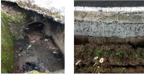
Imágenes 203 y 204. Estado actual cunetas red de aguas lluvias. Fuente: Equipo PEMP 2017
