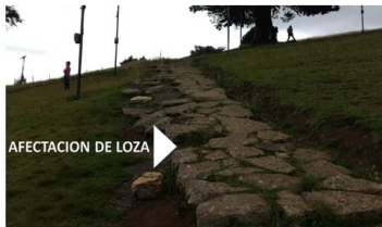
Patología Red Peatonal: Afectación de loza
