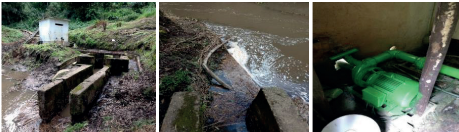
Imágenes 192, 193 y 194. Estación de bombeo interna, bocatoma y motobomba. Fuente: Equipo PEMP 2017
