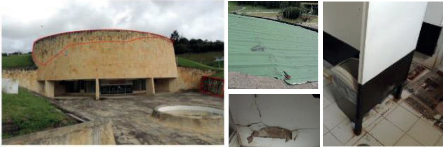
Imágenes 509, 510, 511 y 512. Estado de inmuebles. Fuente: Equipo PEMP 2017.
