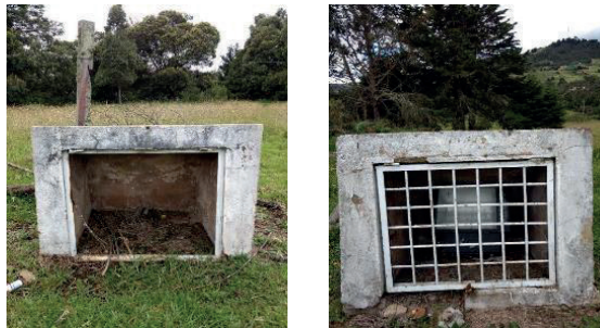
Imagen 187 y 188. Luminarias tipo 3 iluminación conjuntos monumentales – sin lámpara y con lámpara. Fuente: Equipo PEMP 2017
