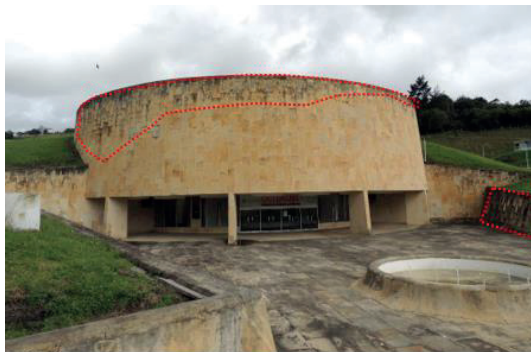
Imagen 262. Acumulación de suciedad en fachada, muros y pisos de exteriores del Ciclorama.
