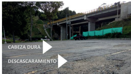
Imagen 157. Patología zona de parqueo 4. Cabeza dura y descascamiento
