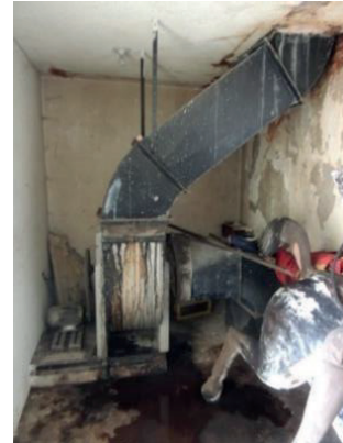
Imagen 253. Equipos de extracción de aire del restaurante Fuente: Equipo PEMP 2017
