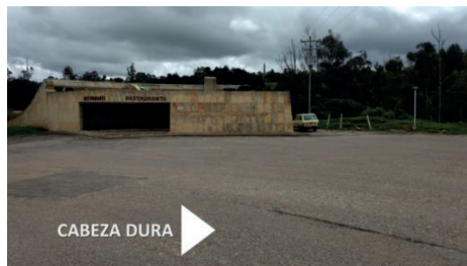
Imagen 158. Patología zona de parqueo 5. Cabeza dura
