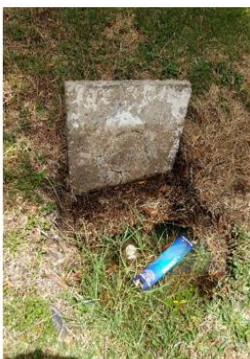
Cajas de inspección agua – Estado de deterioro alto.
