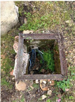
Caja de inspección de energía. Con cables de baja tensión expuestos
