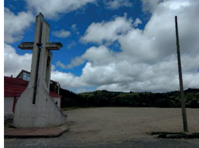
Imagen 154 Patología zona parqueo 1 – sin pavimento. Fuente: Equipo PEMP
