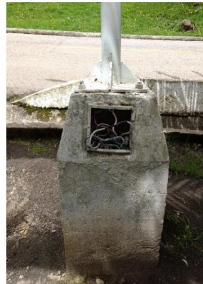
Luminarias tipo 1 ornamental con pedestal – Sin tapa de registro.
