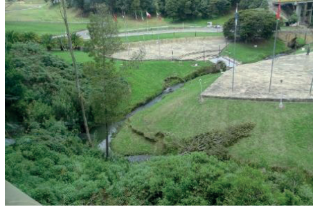
Imagen 131. Pérdida cobertura vegetal. Socavamiento lateral Río Teatinos. Fuente: equipo PEMP.
