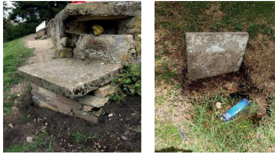
Imágenes 198 y 199. Cajas de inspección agua con deterioro medio y alto.
