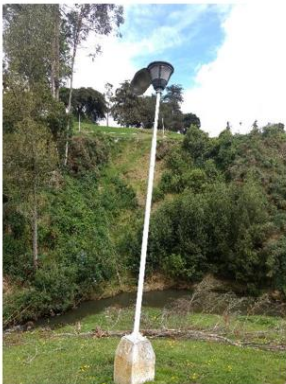
Luminarias tipo 1 ornamental con pedestal – Poste inclinado
