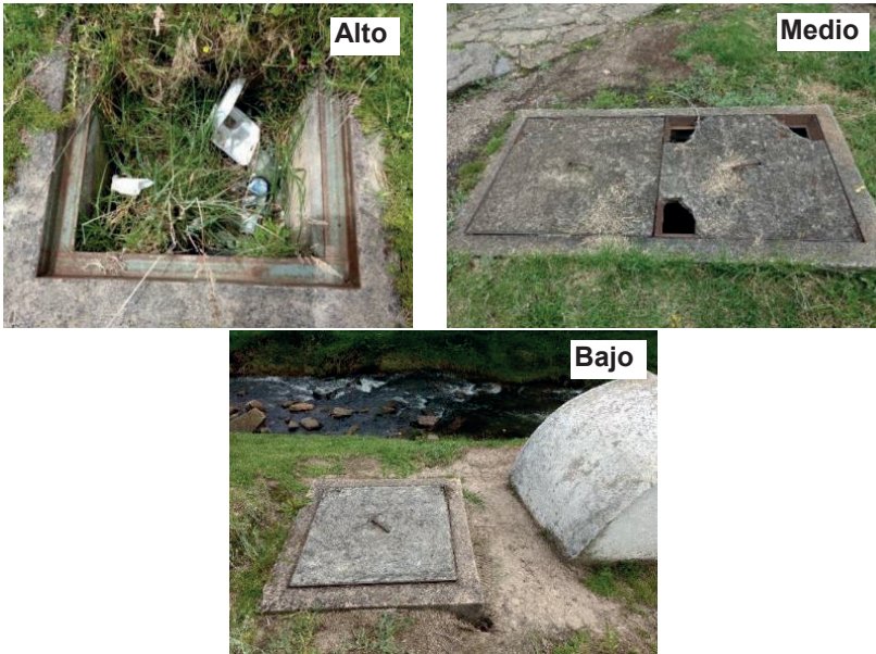
Imagen 166 Cajas de inspección energía con deterioro alto, medio y bajo
